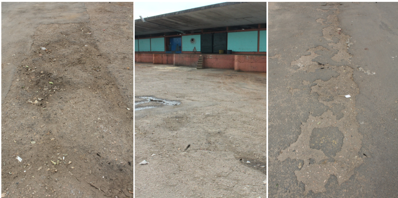
Trechos irregulares do piso entre as rampas de acesso às plataformas do Pavilhão serão corrigidos para facilitar a atividade dos carregadores
