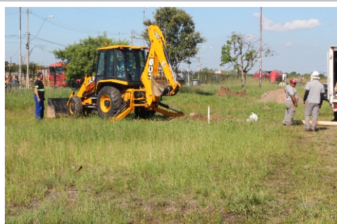
Posto de combustíveis sob análise
