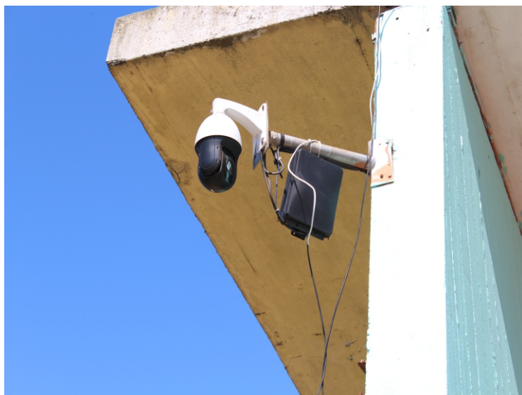
Complexo tem 82 câmeras instaladas. Em breve, serão 115
